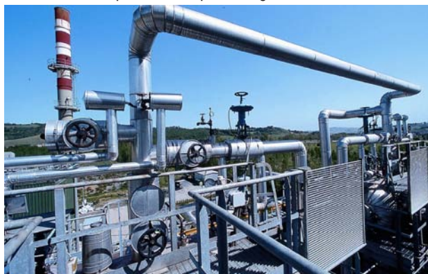
Particolare dell'impianto di recupero energetico
